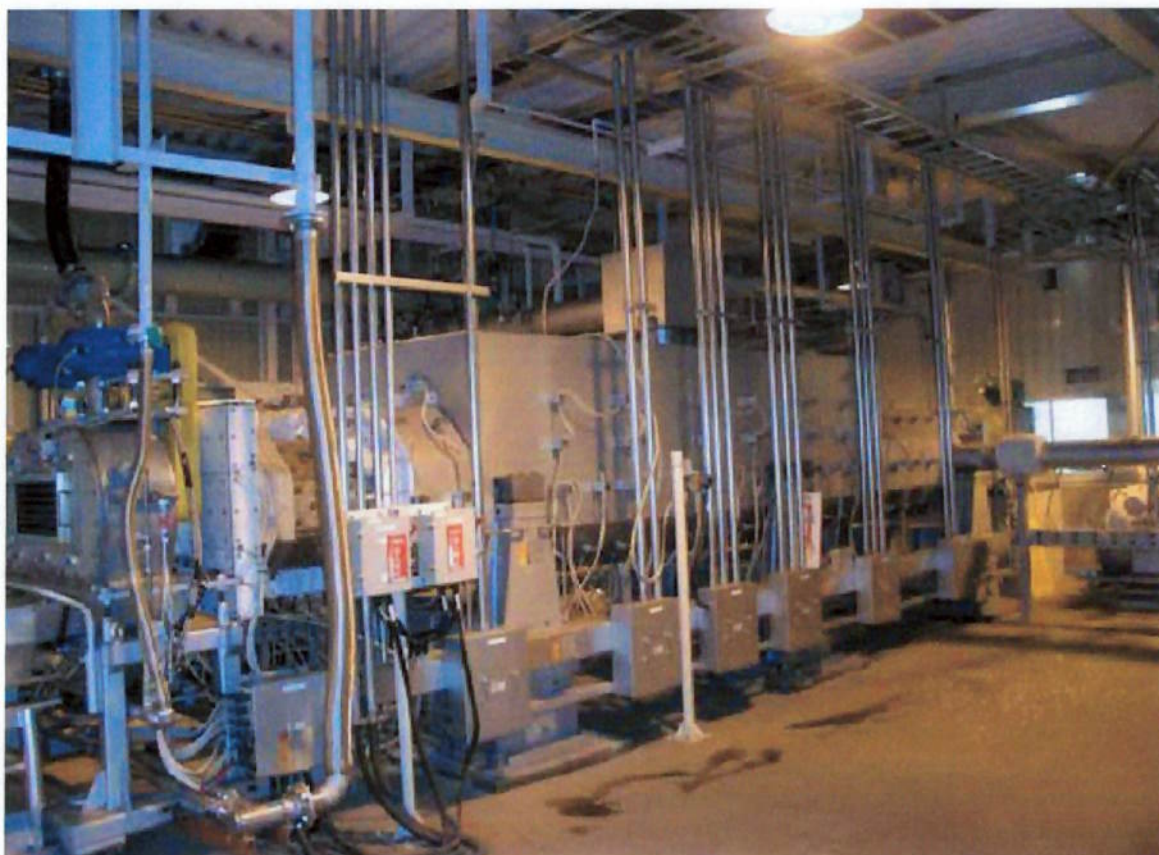
Figura 65 - Unidade de fusão e descloretação
