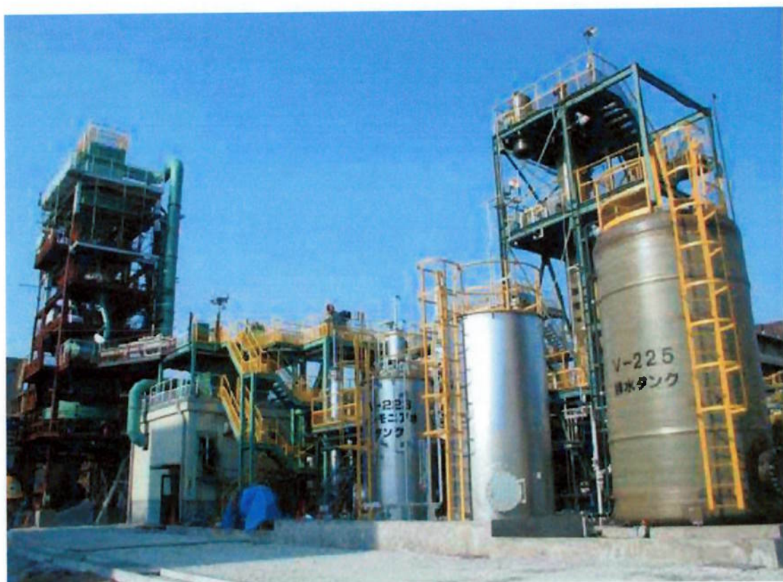
Figura 66 - Unidade de tratamento para neutralização
